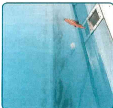
Migration, au travers de la membrane en PVC-P, des pigments contenus dans les panneaux d'une piscine industrialisée.
