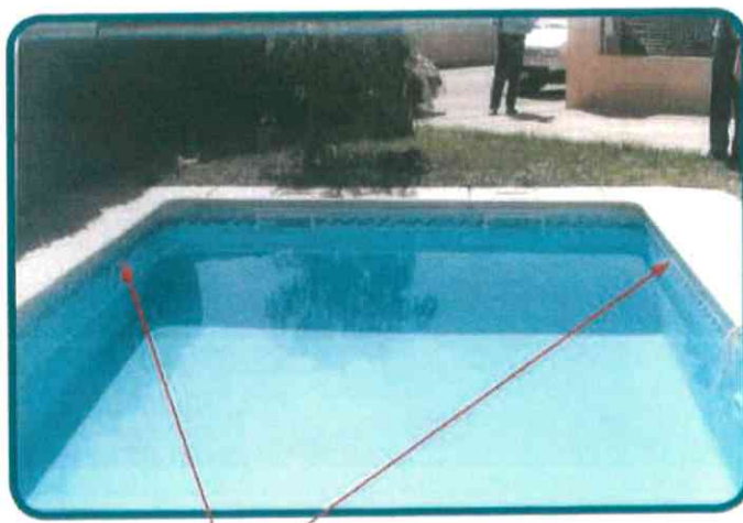
La ligne d'eau de cette piscine est plus fortement encrassée sur sa partie gauche, majoritairement exposée au soleil, que sur sa partie droite.
