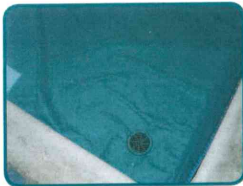
Formation de plis, au voisinage de la bonde de fond, trahissant la présence d'eau sous le liner.
