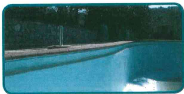
Fort encrassement de cette piscine, dû à un défaut d'entretien manifeste de la ligne d'eau.
