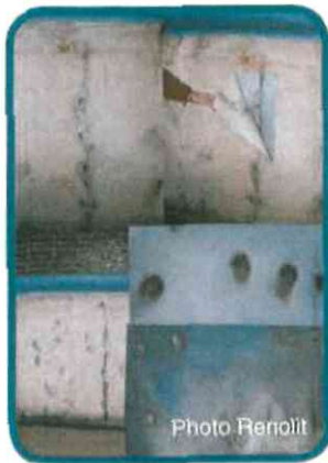
La formation de colonies de bactéries, entre la membrane et son support, a engendré des taches de sulfures métalliques, à la surface du revêtement.
